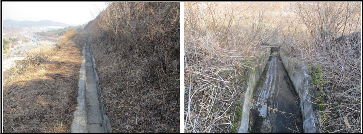
【그림 1.3.3】 배수시설 전경
